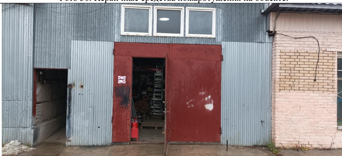
Фото 51. Первичные средства пожаротушения на объекте.
